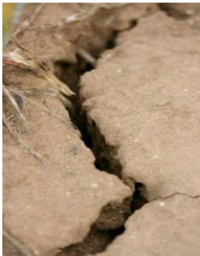
Fig. 15 - Sol argilos cu crăpături
